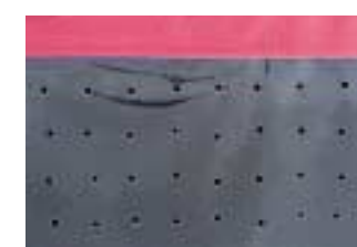
・多孔天井フィルム部
